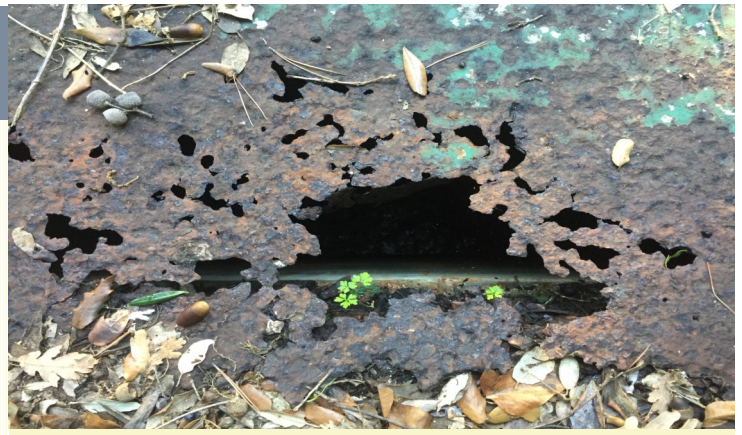
Etat du Canal du Foulon à Grasse
