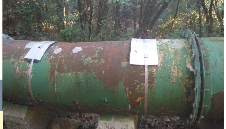
Rustines sur le Canal
