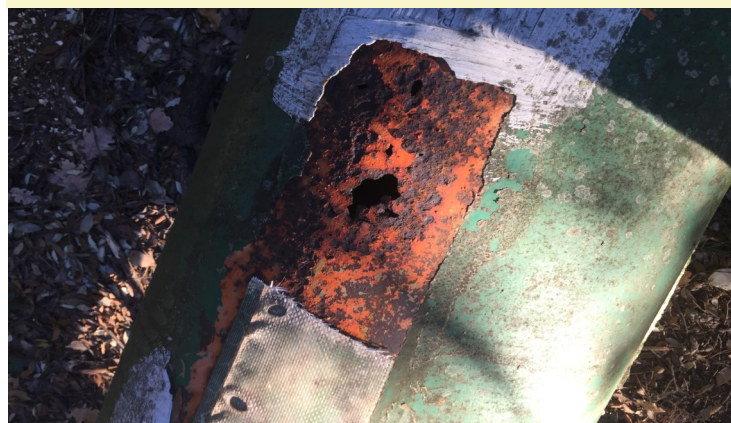
Trous dans le Canal. En 2006 on en dénombrait déjà 69 !
